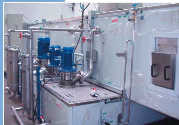
Pumpengruppe mit Filtern und Vorratstank
